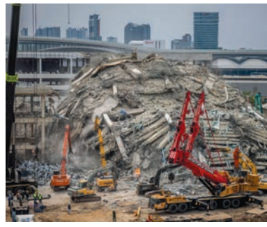
在緬甸地震中倒塌的泰國國家審計署大樓由中資建造商承建。(Getty Images)
